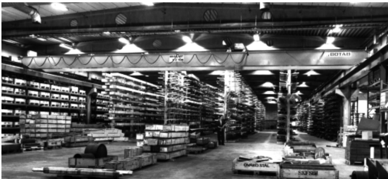
Rälgående traverskran typ RT-2 6,3 tons last vid spännvidd 20 m.
